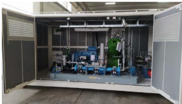
5 pav. Kompresoriaus konteineris
